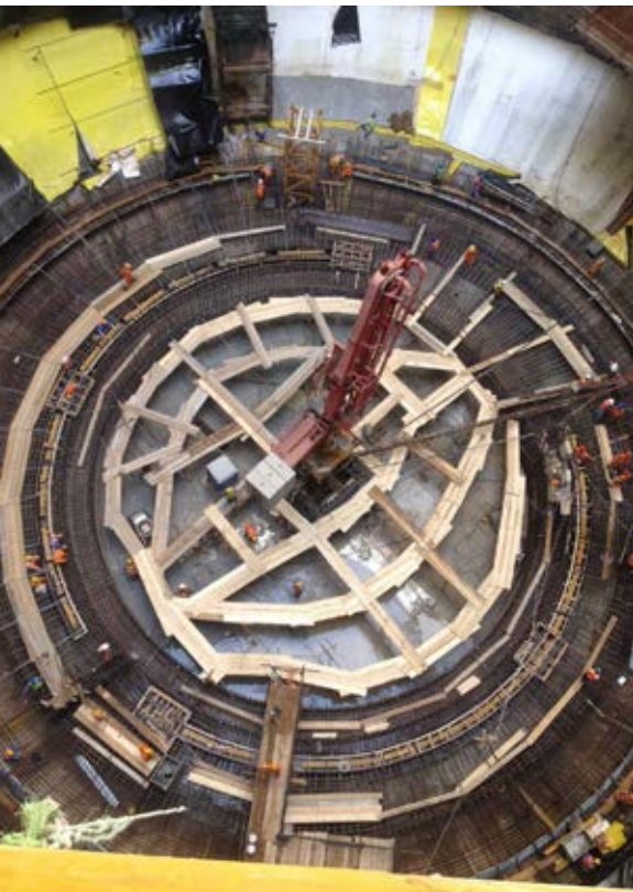
▲ Ein MX 32-4 Stationärmast in 110 m Tiefe
