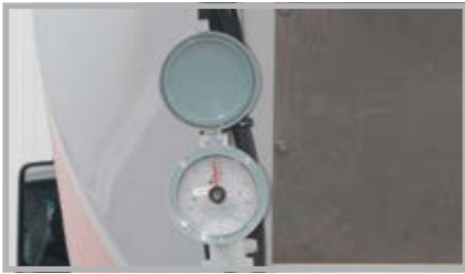
Compteur à eau
