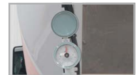
Compteur à eau
