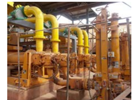
VPD-System, installiert nach einer HSP-Pumpe zur Förderung von Tailings
