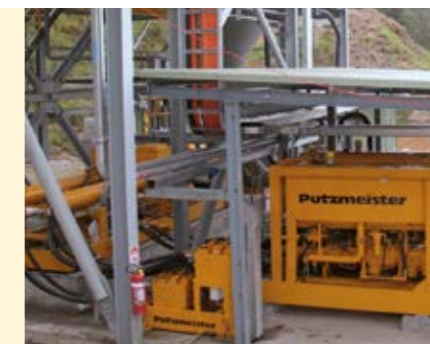
HSP 25100 HPS, клапаны PCF, гидравлический силовой агрегат HA 400
