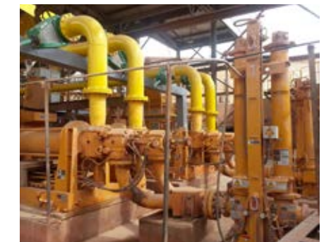
Système VPD installé après une pompe à pistons HSP pour le traitement des résidus
