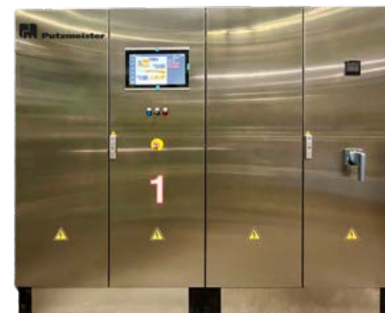
Armoire électrique avec panneau de commande
