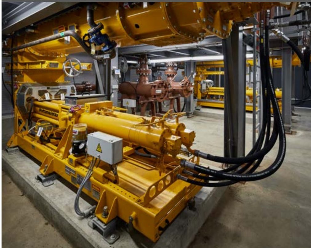
Dickstoffpumpe KOS mit S-Rohr Technik unter Kranabwurfbunker
