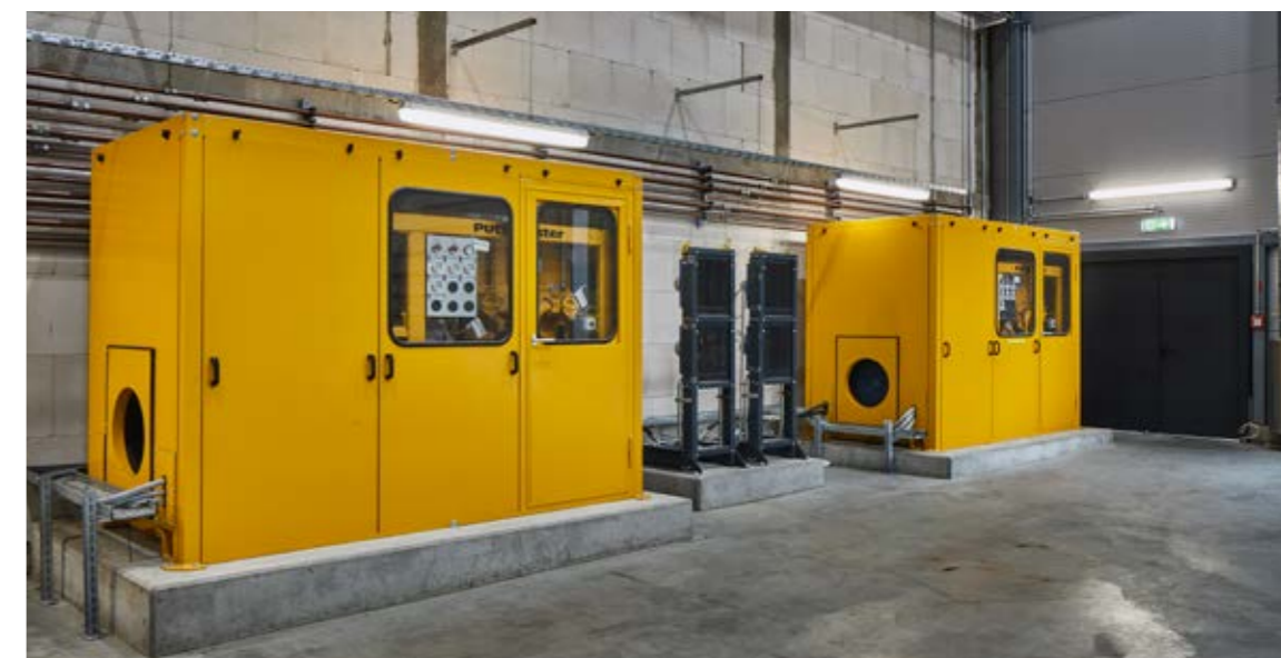
Hydraulikaggregate mit Schallschutzhaube und externem Ölkühler
