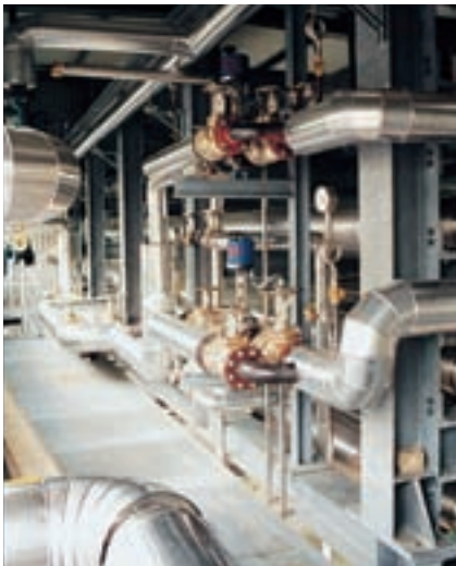
Der gesamte Prozess findet in einer Rohrleitung statt und erlaubt eine kontrollierte Erhitzung
