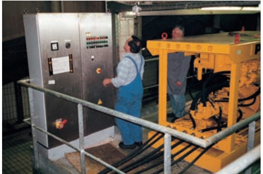
Die zentralen Steuerelemente sind in diesem Schaltschrank auf der Steuerwarte untergebracht. Daneben das Hydraulikaggregat zum Antrieb der Pumpe und der Vorpresseinrichtung.
